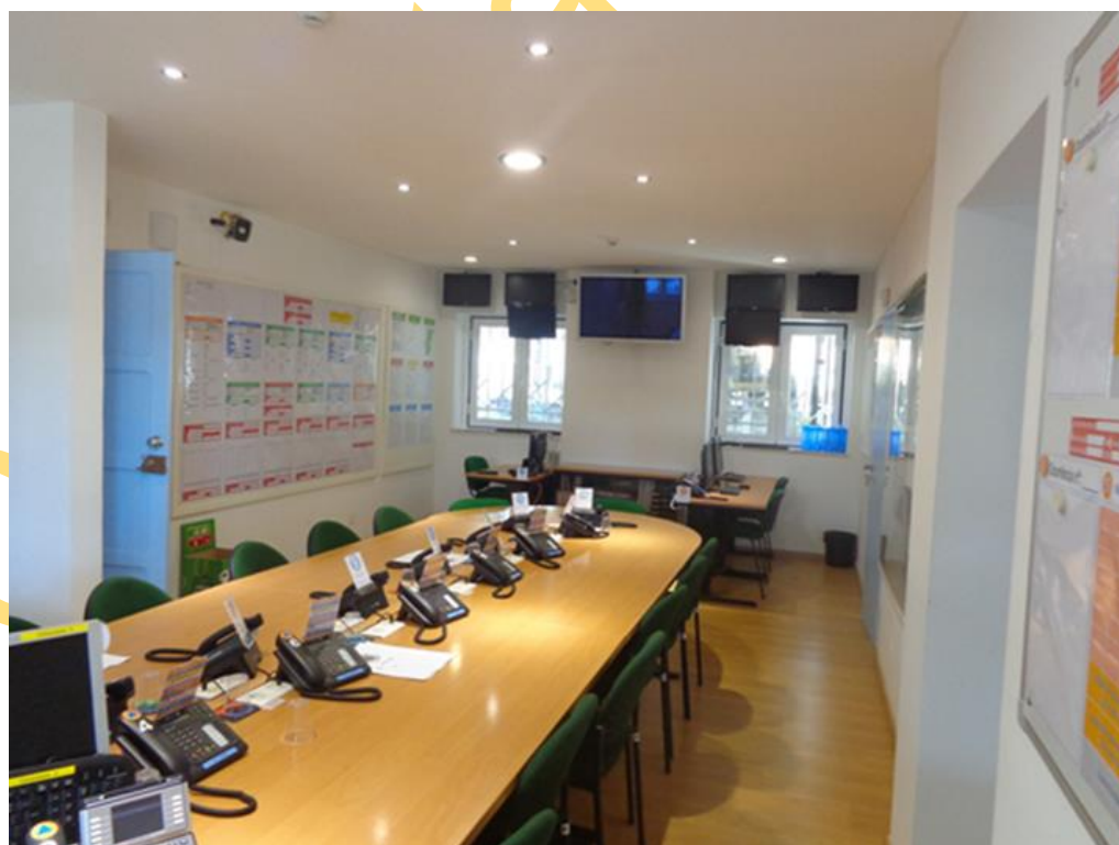
Figura 49 – Sala de operações atual para instalação da CMPC e PCMun
